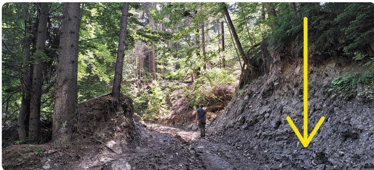
Eroziunea solului pe drumul forestier din pădurea Ingka de lângă Ceahlău, Neamț
